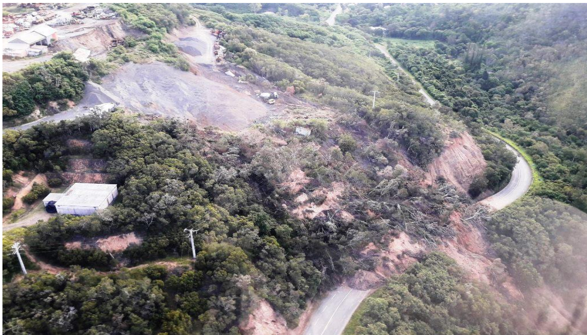
Vue aérienne du glissement de terrain sur la RT1.
